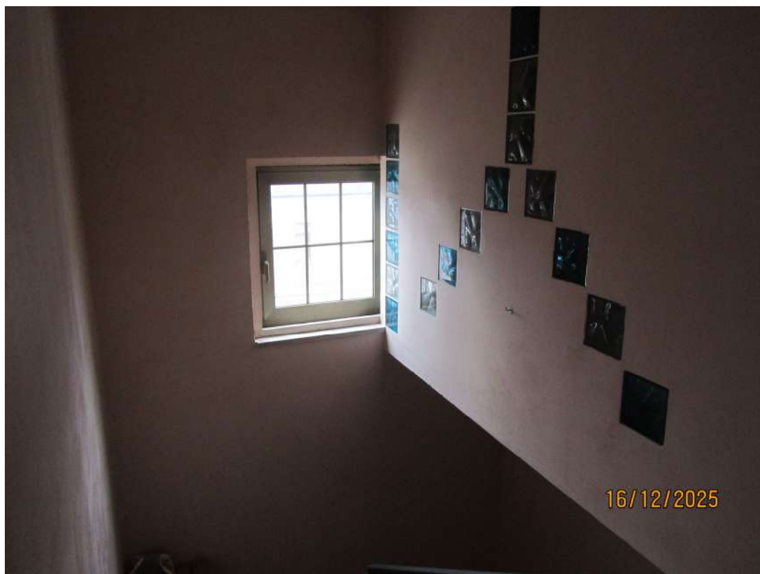
FOTO N. 30 – VANO SCALA – PARETE DEL RIPOSTIGLIO SUL VANO SCALA
