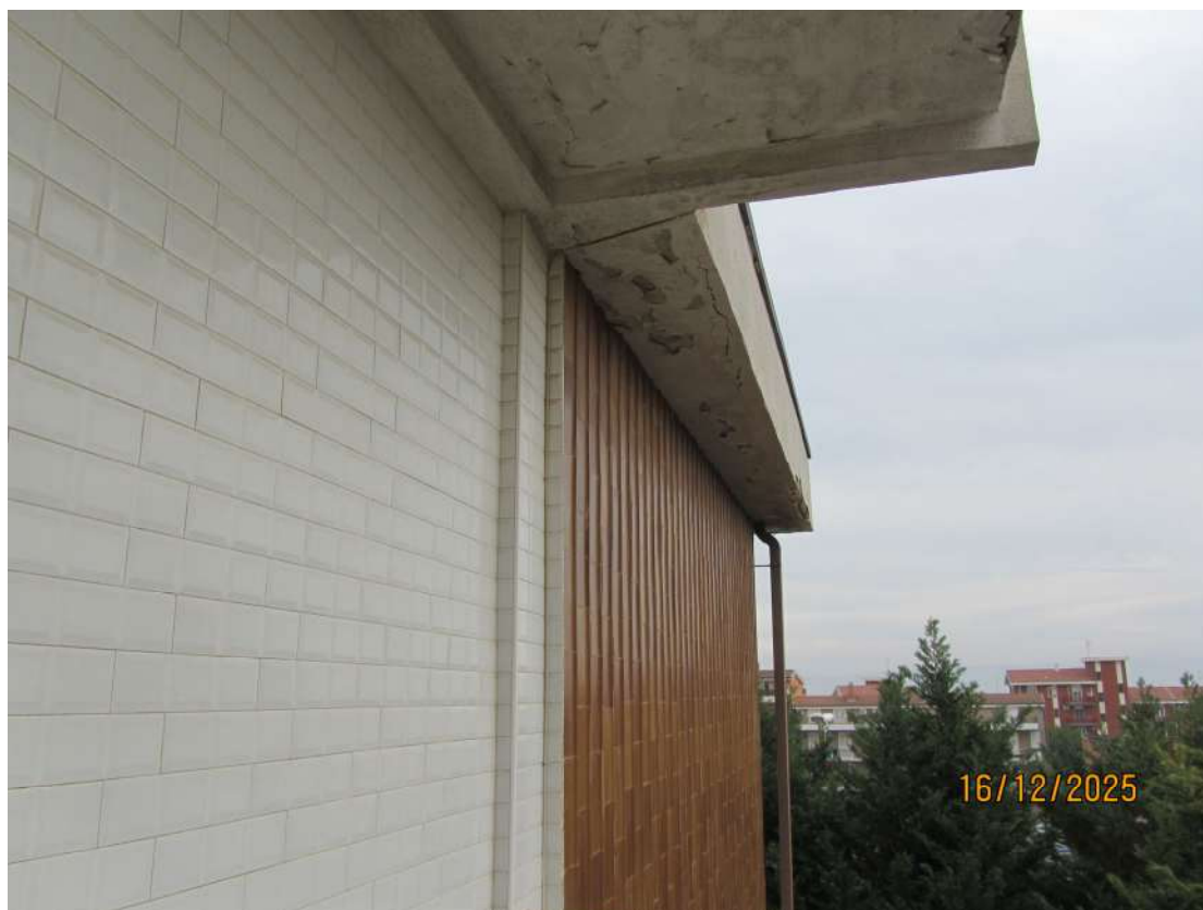
FOTO N. 18 – STATO MANUTENZIONE CORNICIONE
