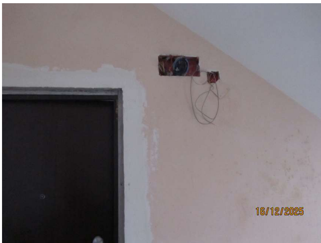
FOTO N. 7 – IDEM C.S. – PARTICOLARE CASSETTA IMPIANTO ELETTRICO
