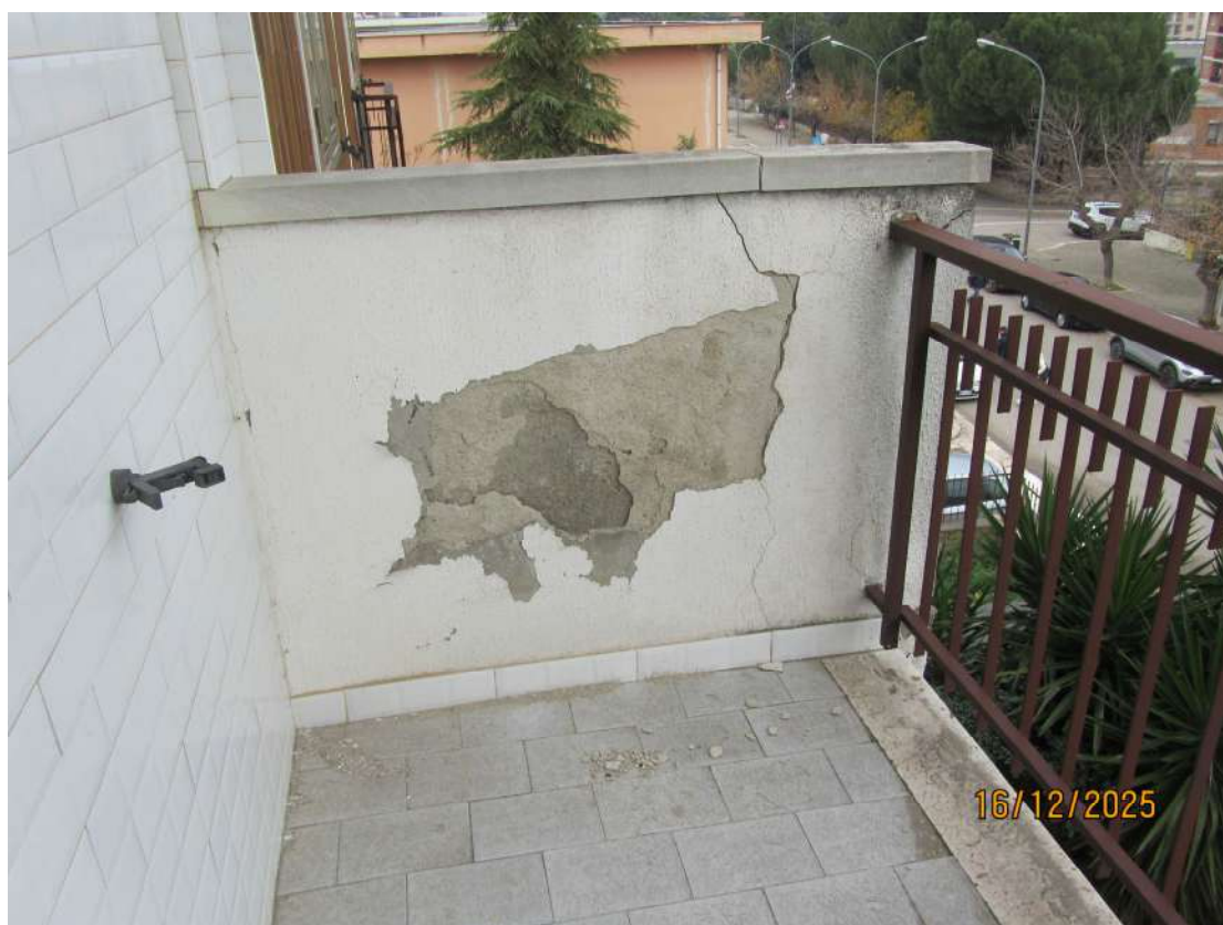
FOTO N. 15 – PARTICOLARE STATO MANUTENZIONE VELETTA BALCONE
