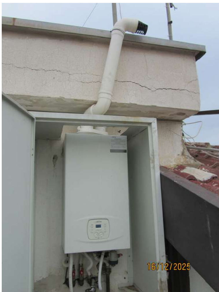
FOTO N. 32 – POSIZIONE DELLA CALDAIA A GAS UBICATA SUL TERRAZZO ESTERNO
